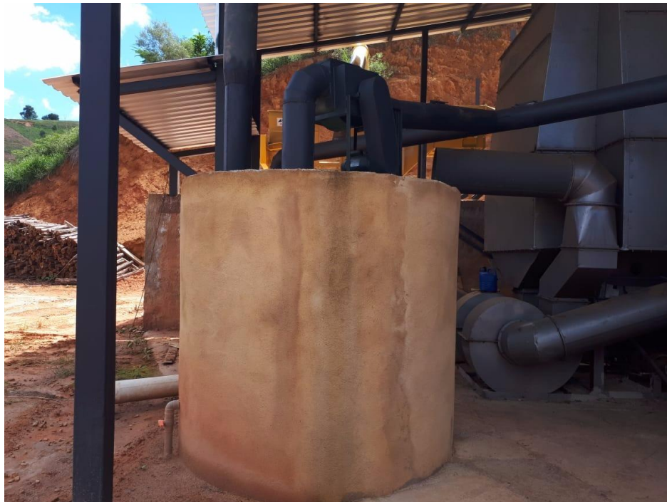
Figura 2: Duto coletor do ar contaminado. Fonte: Elaborado pelos autores (2018).
