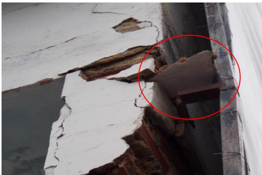
Figura 4 – Parte do revestimento desprendido no exterior do Terminal Rodoviário Roberto Silveira. Fonte: Os autores, 2021.
